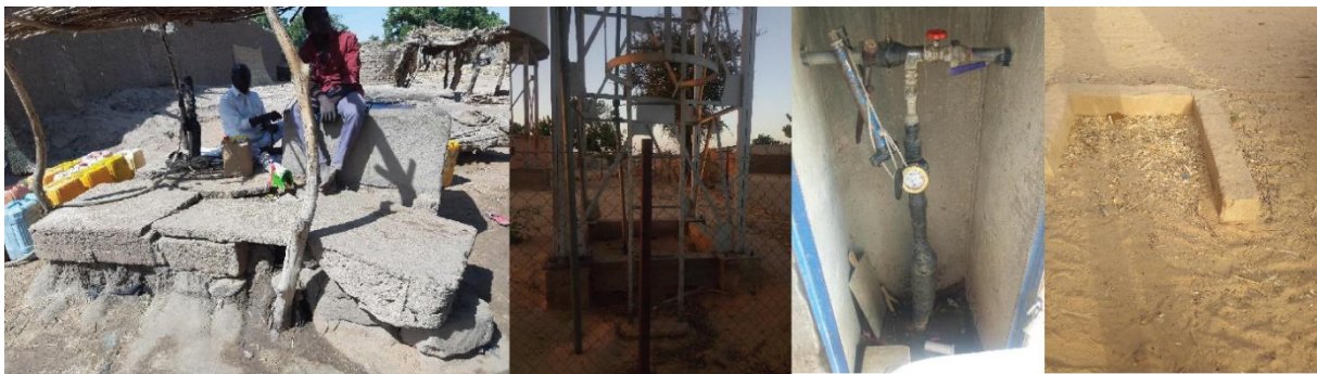
Planche Photo 3 : Etat de quelques infrastructures du réseau AEP.
