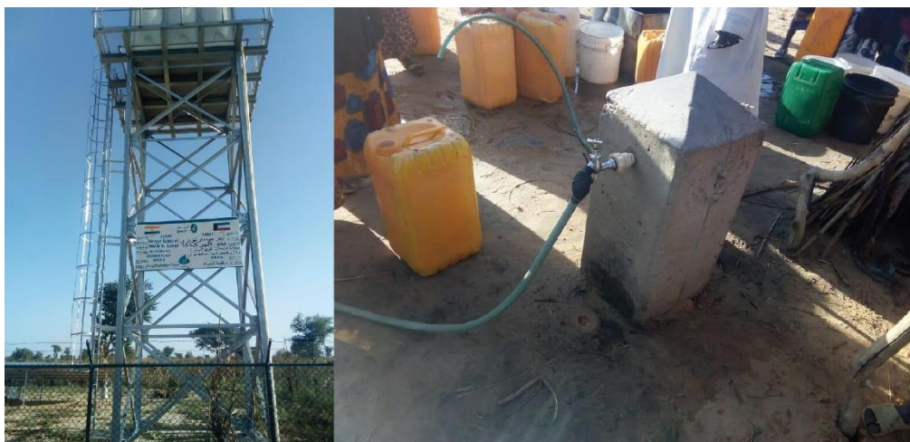
Planche Photo 2 : Poste d'eau AMA de Dan Guiwa (CR de Kanembakaché).
